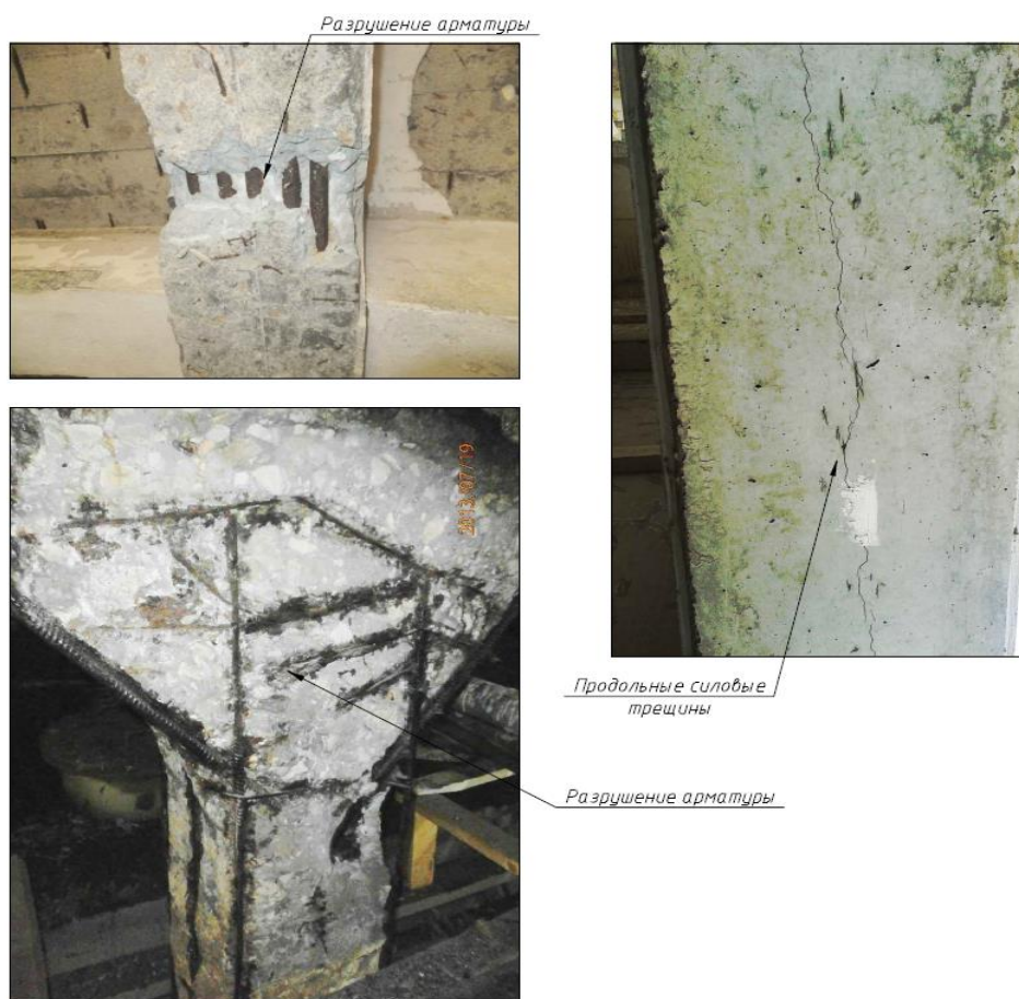
Рисунок 5.1 Примеры дефектов, устраняемые системой внешнего армирования CarbonWrap®
