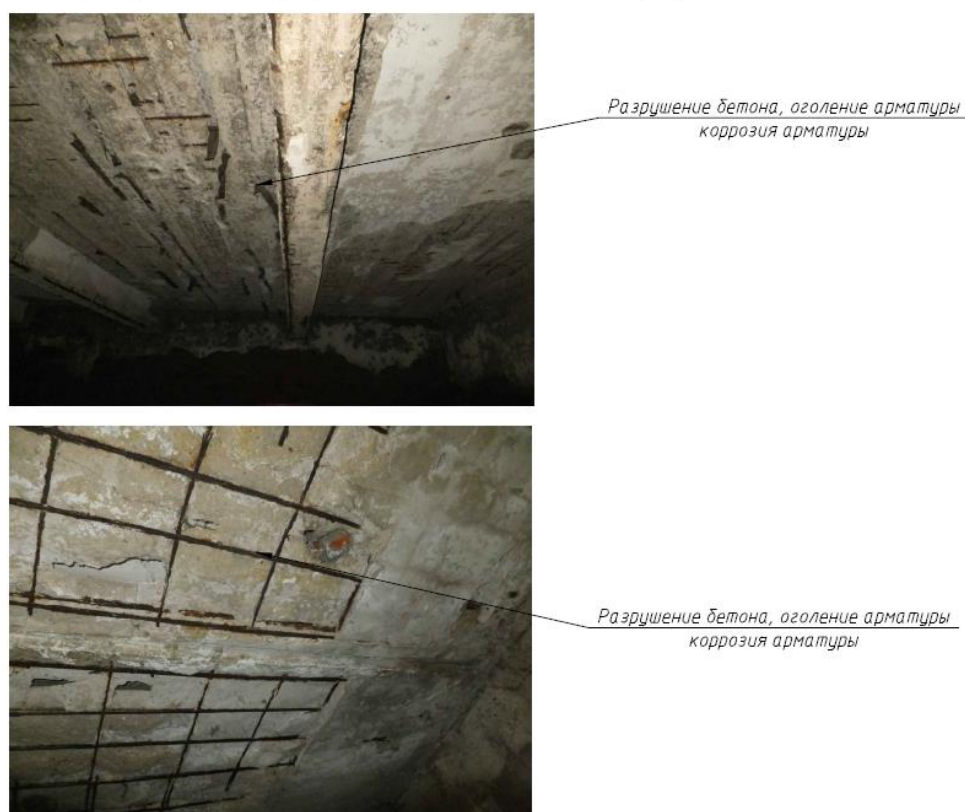
Рисунок 5.79 Примеры дефектов, устраняемые системой внешнего армирования CarbonWrap®
