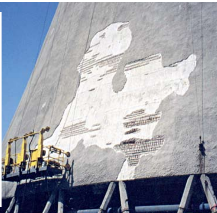
Разрушение поверхности гравитации, вызванное карбонизацией бетона.
