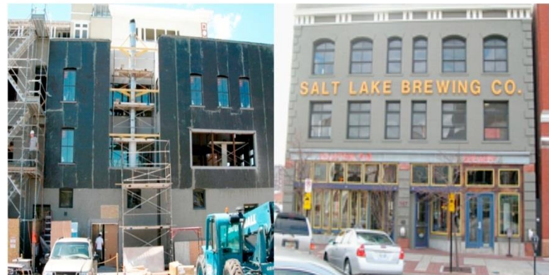
Сейсмоусиление здания (США, штат Юта)
