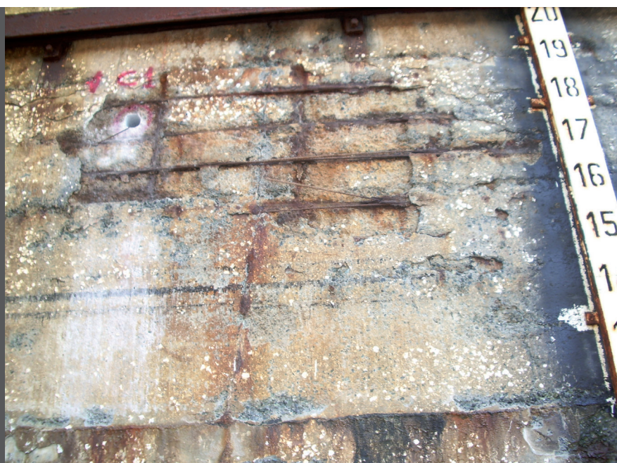
фото 10 Коррозия в результате воздействия хлоридов
