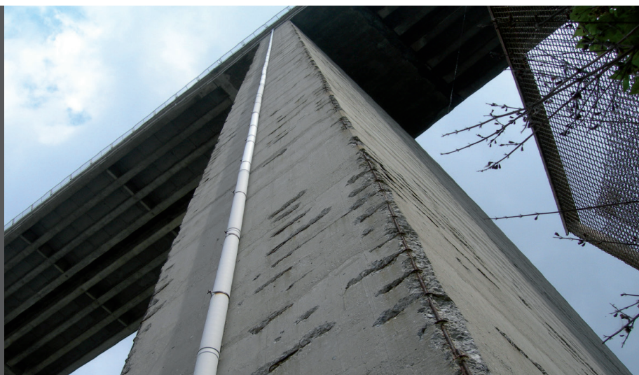
фото 3 Пример разрушения, вызванного внешней средой
