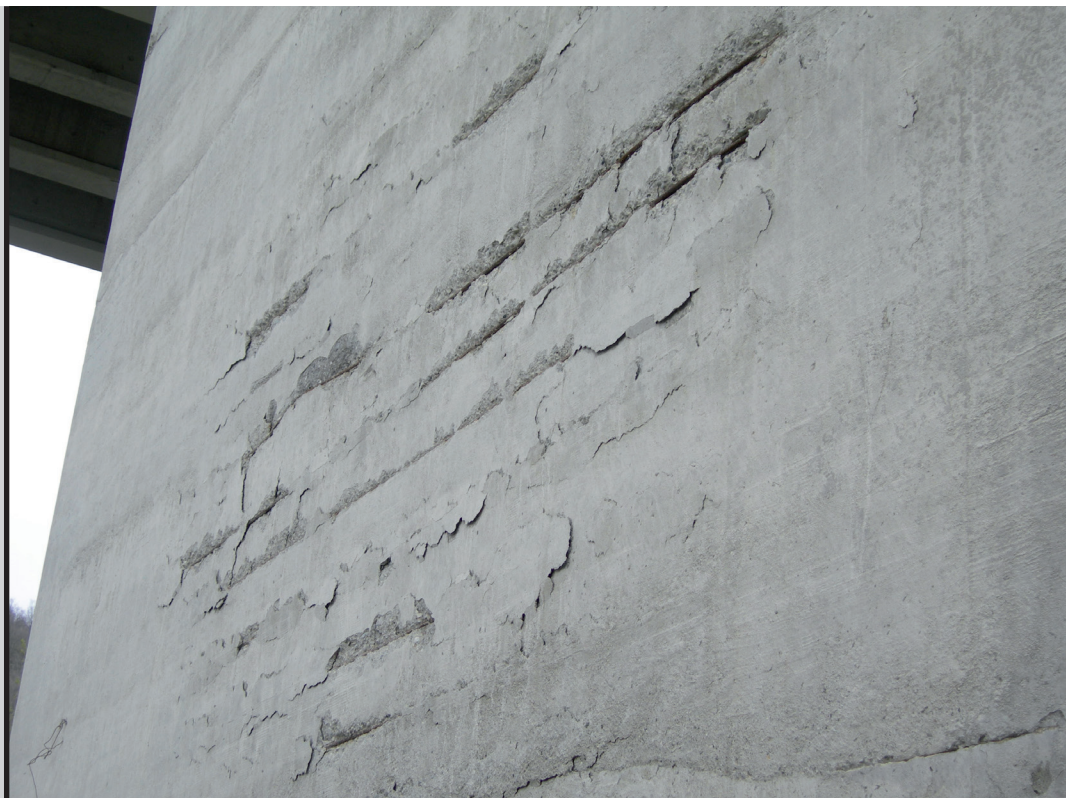
фото 4 Разрушение сооружения вследствие коррозии арматурных стержней
