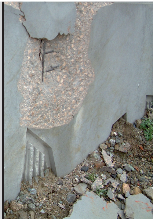
фото 15 Разрушение в результате замерзания
