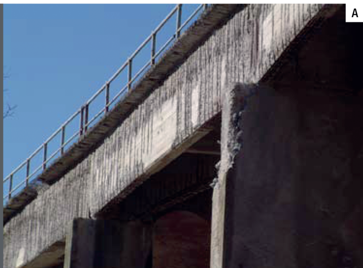
фото 24 А Бетонное сооружение до ремонта
