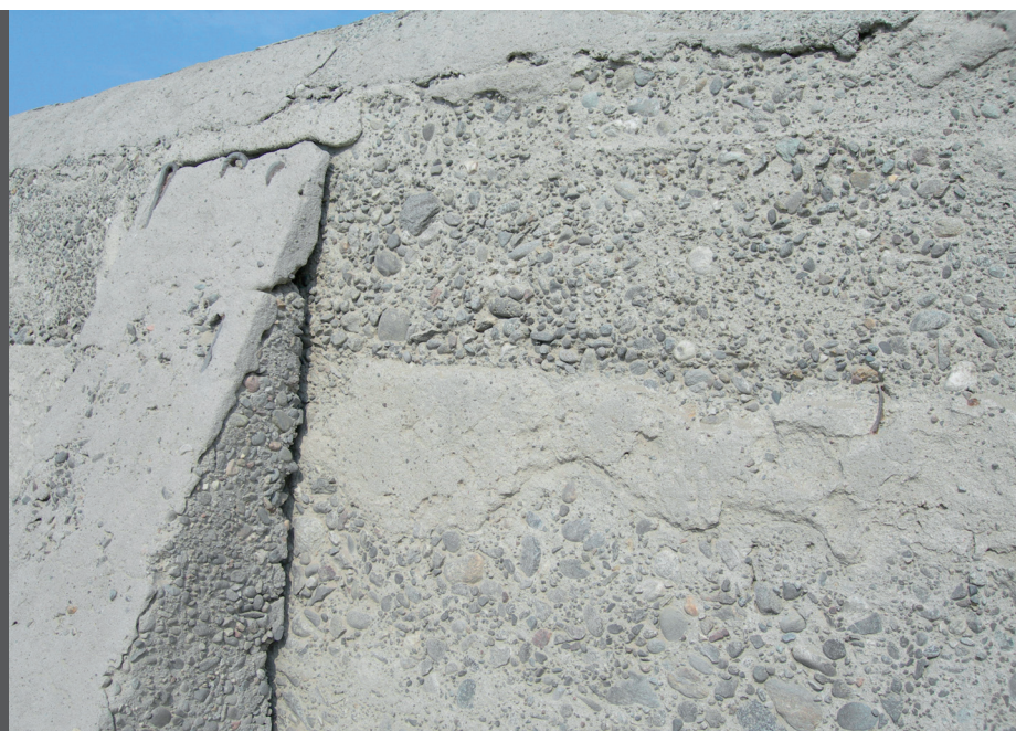
фото 5 Влияние на поверхность бетона выщелачивания
