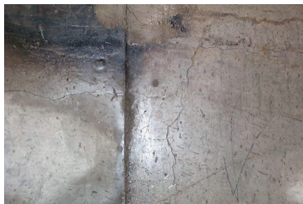
Рис. 2. Усадочные трещины на поверхности стены автодорожного тоннеля
