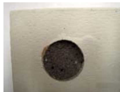
Фото 5. Характер разрушения при испытаниях на адгезию образца после 135 циклов ускоренных климатических испытаний (покрытие Elastocolor Paint). Отрыв по телу бетонного основания; прочность сцепления покрытия с основанием больше полученного значения.
