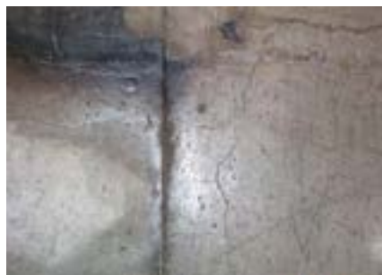
Рис. 2. Усадочные трещины на поверхности стены автодорожного тоннеля
