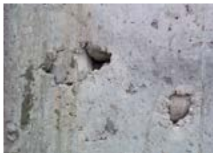
Рис. 1. Зависание бетонной смеси в зоне «сухареи»
