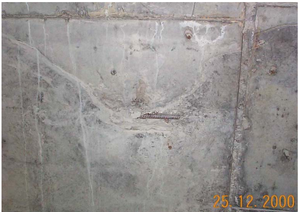
Рис. 1. Участок стены с оголенной арматурой
