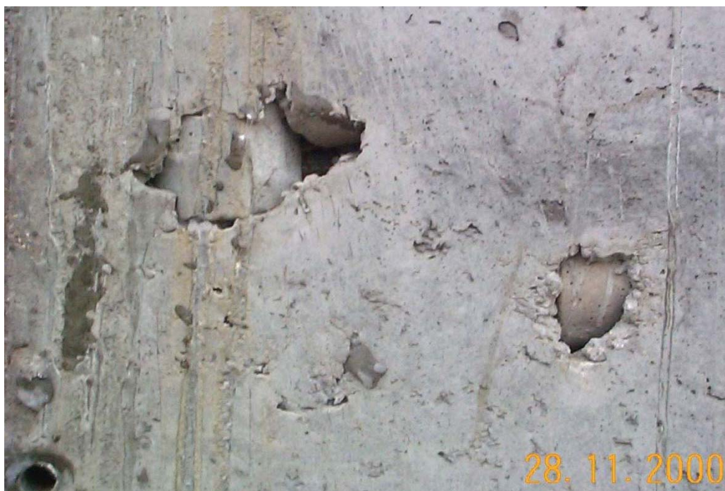
Рис. 5. Зависание бетонной смеси в зоне «сухарей»
