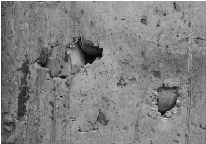
Рис. 5. Зависание бетонной смеси в зоне «сухарей»
