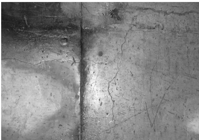
Рис. 6. Усадочные трещины на поверхности стены автодорожного тоннеля
