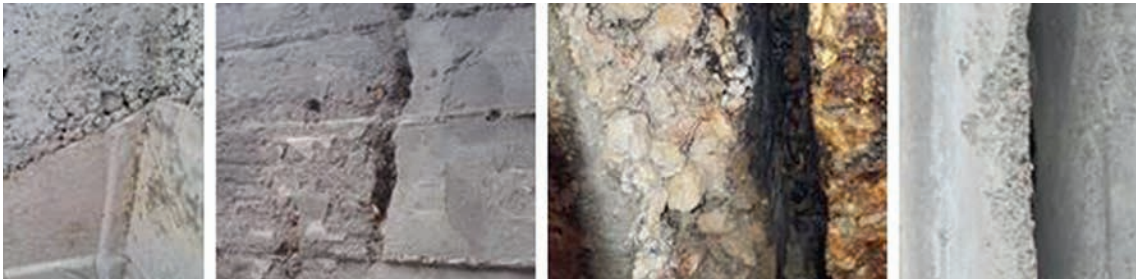
Рисунок 6.3.1.1 – Поверхностные дефекты бетона
