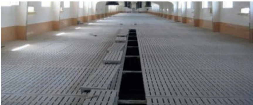
Рисунок 4.4.1.2 – Бетонные ванны сбора отходов, накрытые щелевыми полами
