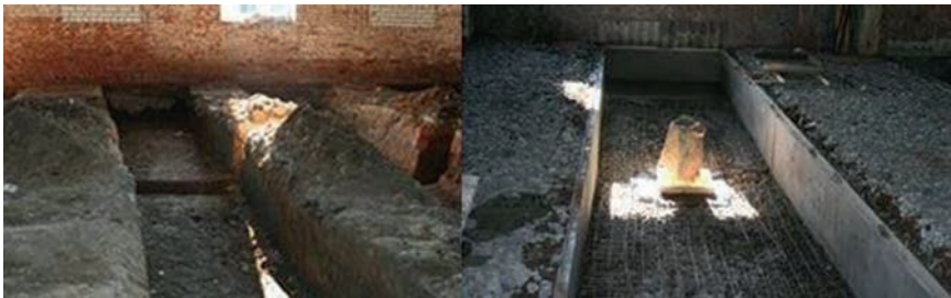
Рисунок 4.4.1.3 – Бетонные ванны свинарника со значительным разрушением
