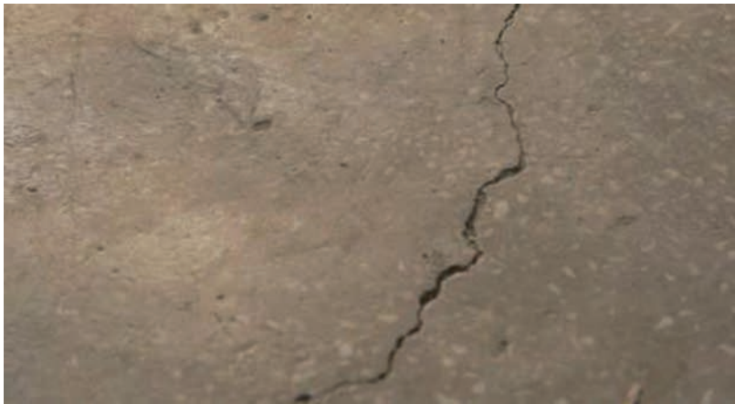
Рисунок 6.6.1 – Подвижная трещина в полу
