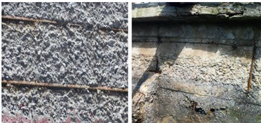
Рисунок 6.3.2.1 – Разрушенные участки бетона с оголенной арматурой
