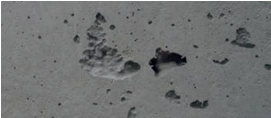
Рисунок 6.3.6.1 – Дефекты бетонной поверхности
