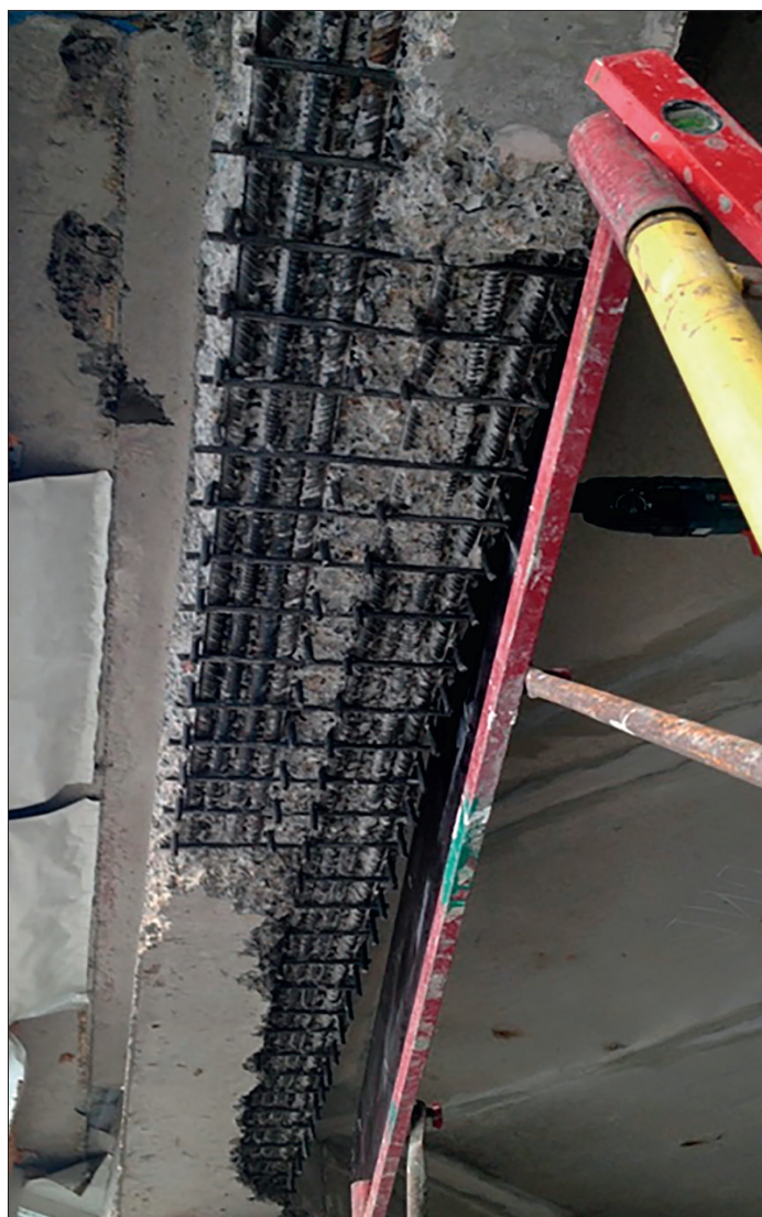
Рисунок 9 – Монолитные участки железобетонных балок с участками оголенной арматуры
