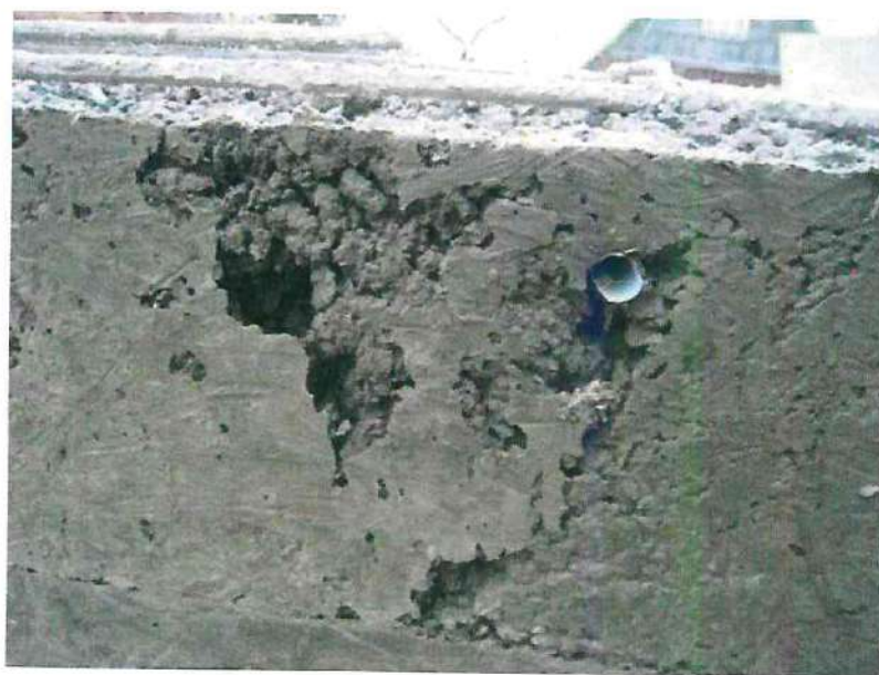
Рисунок 6.4 – Непровибрированные участки стены
